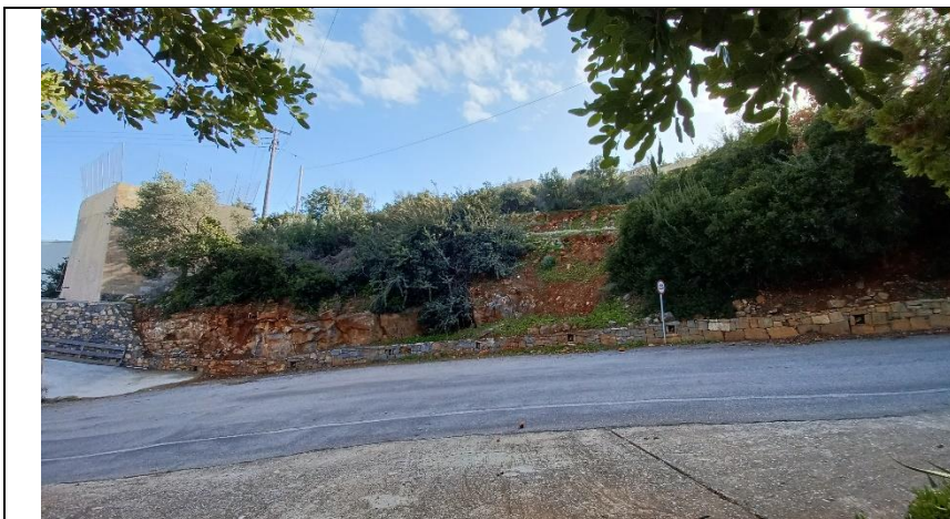
Φωτ. 5 Χ.Θ. 0+792. Εδαφικός μανδύας σε περιοχή αυξημένης κλίσης, (sc1). Άργιλοι, άμμοι και χάλικες, ερυθροκαστανού χρώματος ο Στην εικόνα έχουν πάχους 1-2 m. Βρίσκονται πάνω από πλακώδεις ασβεστόλιθους (Jm-Es.k1 ). Στη θέση προβλέπεται η σύνδεση του κύριου κλάδου με τη συνδετήρια οδός προς Aquila Elounda Villas. Προβλέπονται τοίχοι αντιστήριξης στο πρηνές.
