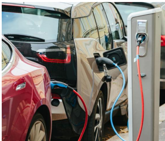
Εικόνα 41: Σταθμός φόρτισης ηλεκτρικών οχημάτων στο πεζοδρόμιο. Υποστηρίζει θέσεις (ελεγχόμενης) στάθμευσης παρά την οδό.
